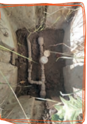
Compteur d'eau école
